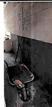
Foto 6: Filtración de agua externa en muro perimetral
