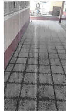
Foto 4: Sustitución de piso con salitre
